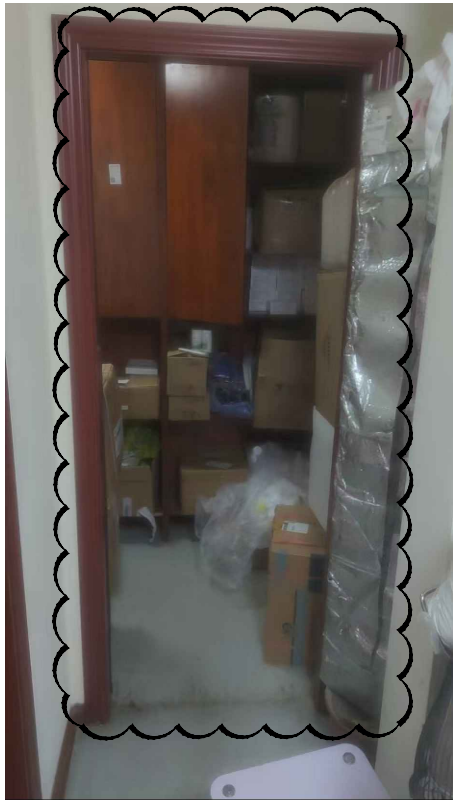
综合楼三楼热成像检查室门框损坏，更换800*2000实木复合门
